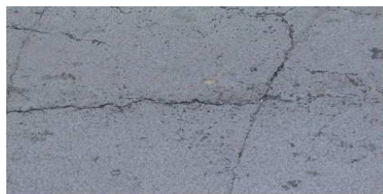
شکل ۱۱- نمایی از ترک‌های ایجاد شده بر پوشش فتوکاتالیستی اعمال شده بر روی آسفالت خیابان در ایتالیا [۳]
